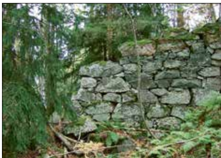
Buksedammen. Hit stod dammen før muren falt.
